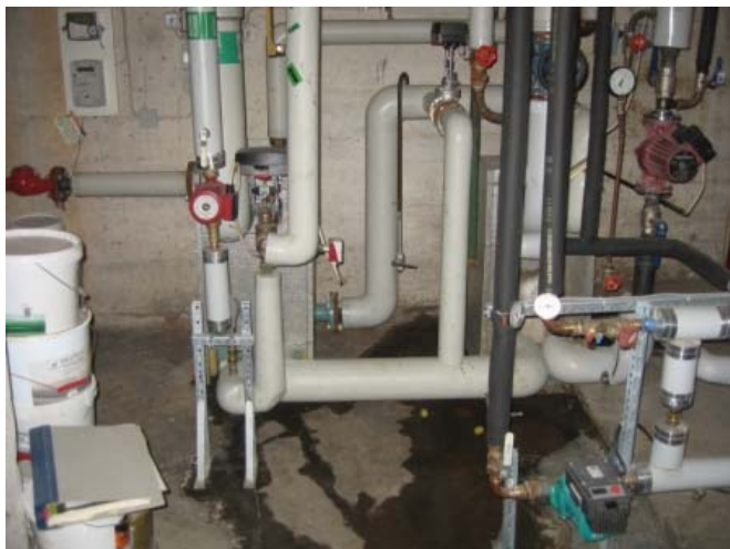
Fjärrvärmväxlaren i fastigheten
