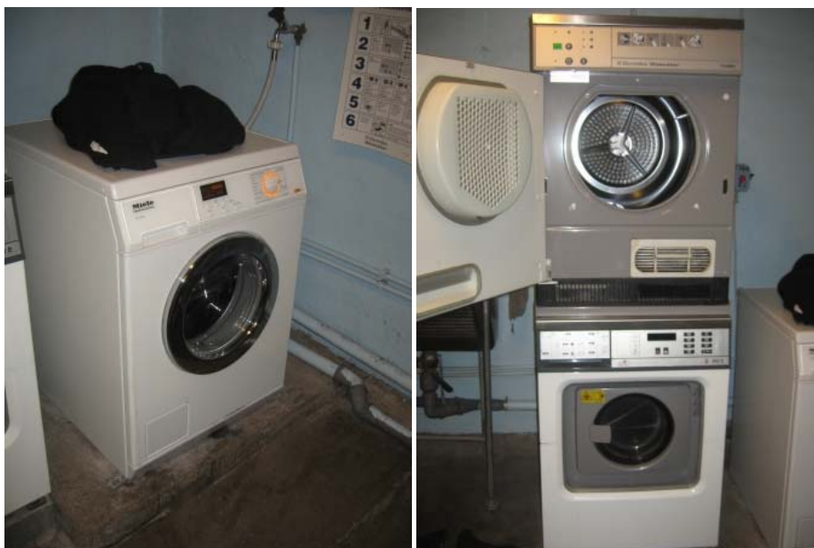
Tvättstugan i fastigheten.
