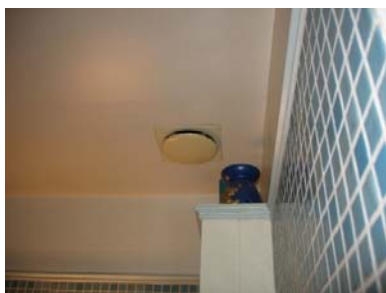
Frånluftskanal i en av referenslägenheterna.
